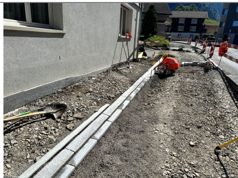
21.05.2026 / Bödeli – Versetzen von Randabschlüssen
