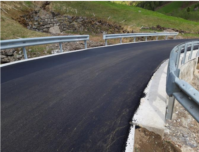
TS 2 am 21.04.2026: Deckbelagseinbau im Bereich der unteren Gigenbachbrücke. Der Belag ist bündig mit Oberkant Randbord resp. leicht überbaut.
