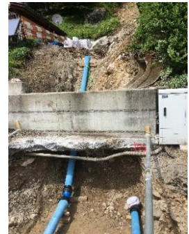
Zuleitung ab Strasse Brand
